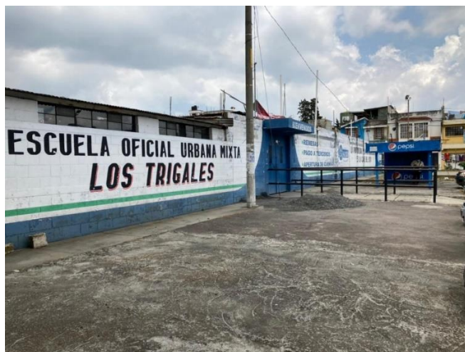
Demuestra el estado de la fachada de la escuela Oficial Urbana Mixta de la Colonia Los Triguales. Elaboraci3n propia 29 de septiembre de 2021.
