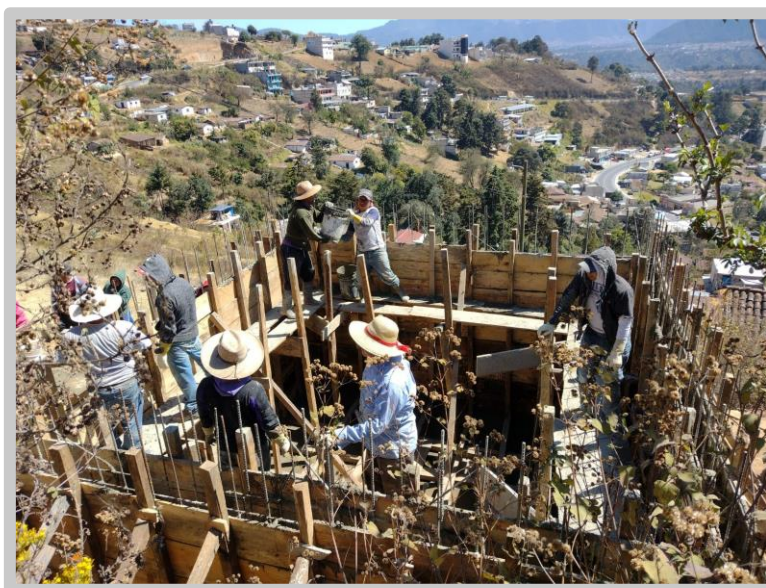
Figura 10. Supervisión de la fundición del tanque de distribución de aldea Cajolá Chiquito, Cajolá, Quetzaltenango.
