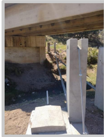
Figura 11. Construcción del paso aéreo en aldea Cajolá Chiquito, Cajolá, Quetzaltenango. Fuente: Elaboración propia
