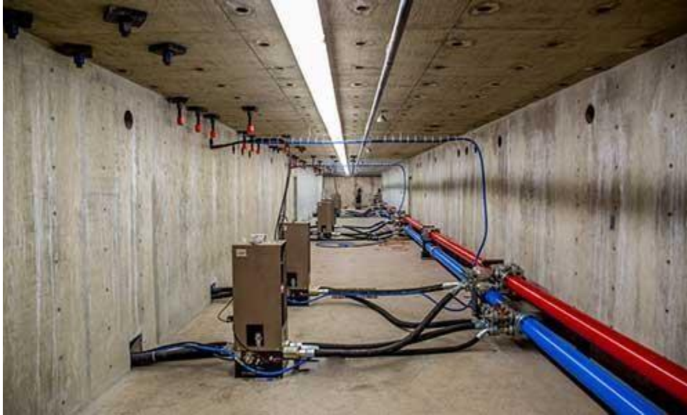
Ilustración 6. Sistema hidráulico y eléctrico del Centro de investigación de terremotos en ingeniería civil de la Universidad de Nevada Reno, Estados Unidos.
