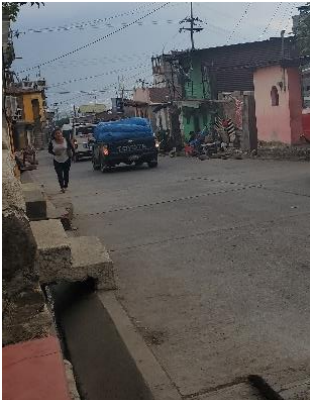
Fotografía No.60 Alcantarillado pluvial Elaboración: propia.
