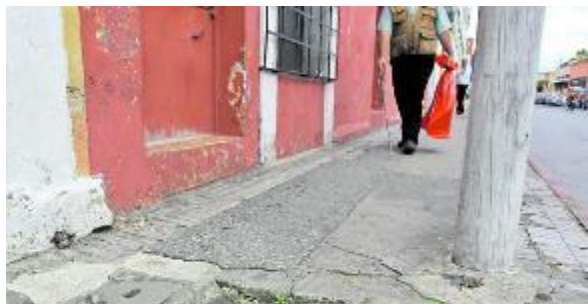
Fotografía 11 - Banquetas deterioradas en ciudad de Guatemala. Fuente: Prensa libre
