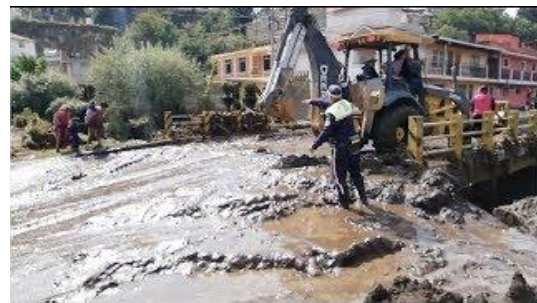
Imagen 8 Problemática en la carretera Cito 180 Fuente: https://conred.gob.gt/boletines-informativos/
